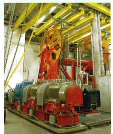
Der Antriebsraum mit den zwei unabhängigen Antriebsätzen für die Parallelanlage
