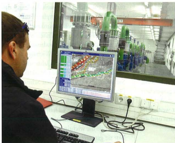
ATASSplus bringt die gesamte Beschneiungsanlage auf den Bildschirm und ermöglicht eine effiziente und bequeme Steuerung.
