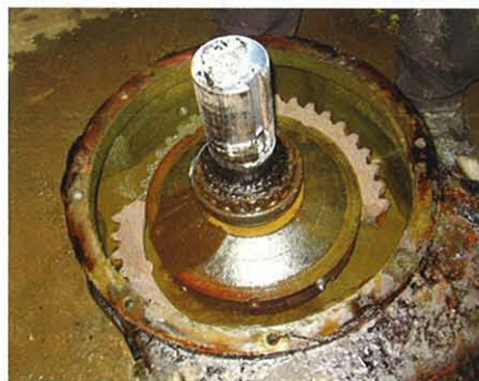
Blick in das geöffnete Hauptgetriebe
