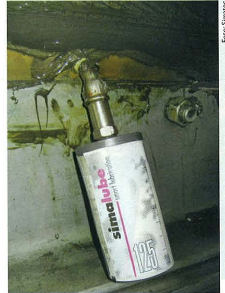
Automatische Schmierung des Tragseilschuhs mit simalube
