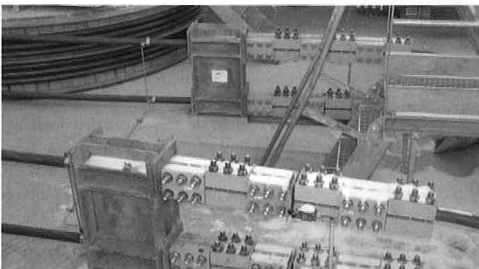
Bild 7: Verankerungsklemmen für die Tragseile in der Bergstation. Links oben die Verankerungstrommel für die Bergfahrtseite.
