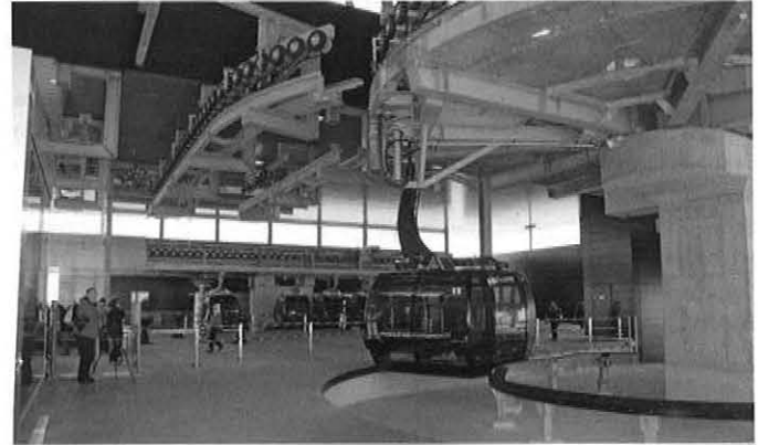
Bild 4: Anbindung des Abstellbahnhofs für die derzeit 9, später 19 Fahrzeuge der 35-Bahn an die Hauptfahrbahn mittels Hub-Drehweiche (Bildmitte oben). Im Hintergrund die Ausstiegstelle der 8er-Kabinenbahn.
