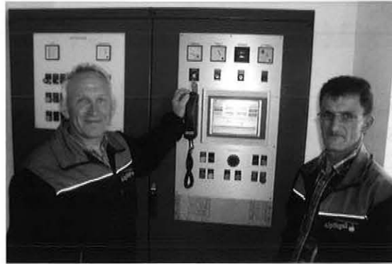
Die gesamte Elektro-Technik der Anlage stammt von der Firma Sisag aus Altdorf. Links Sepp Fässler-Wyss und der Betriebsleiter Albert Neff.
