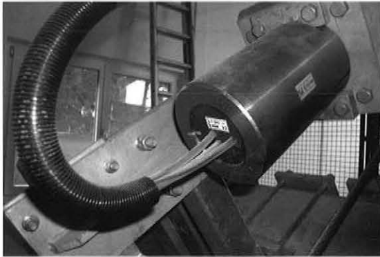
Durch das Trageseil führen drei Kupferdrähte, welche der Versorgung der Steuerung in der Bergstation dienen. Auf dem Bild gut erkennbar die Kunstharz-Vergusschülse mit den drei Kupferleitern.
