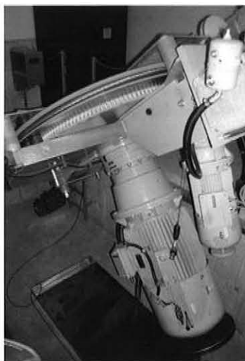
Der Antrieb und der Notantrieb befinden sich in der Talstation.
