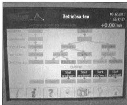
Dieses Touch-Pannel gehört zu der SPS Steuerung; das Bild zeigt die aktive Bedienerhilfe an (aktive Matrix).
