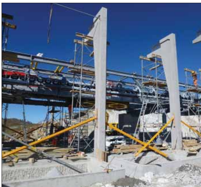
Hochbau und Seilbahntechnik entstanden mit akribisch geplanter Logistik parallel, um die Fertigstellung in kurzer Zeit zu garantieren.
