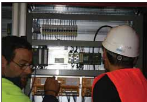
Inspektion der Steuerung: Markus Koller (tytec AG), Pius Kühne (KWS AG) Fotos: tytec AG
