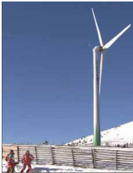
Die innovative LEITWIND-Windkraftanlage im Skigebiet Salzstiegl in der Steiermark.
