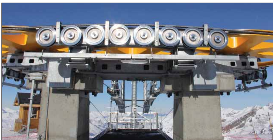
Die dreifache Seil-Umlenkung. Bei der Antriebsstation unterscheidet sich die BMF-Lösung von der „klassischen“ Funitel-Technik, indem Antriebs- und Umlenkungsräder besonders platzsparend auf ein - zweifach umschlungenes - Antriebsrad zusammengeführt werden.
