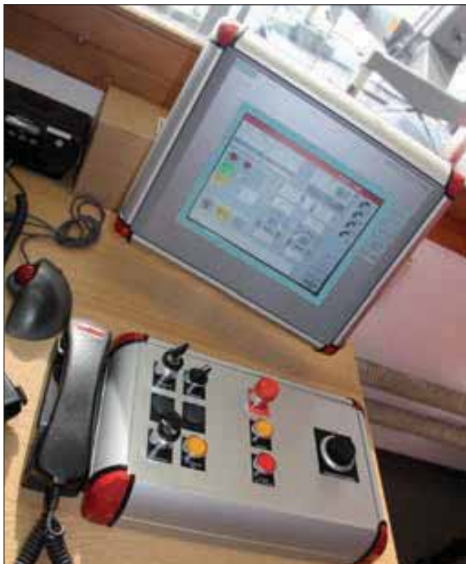
Bei der Erneuerung der Luftseilbahn wurde die komplette bahntechnische Elektroausrüstung durch eine moderne Seilbahnsteuerung ersetzt.
