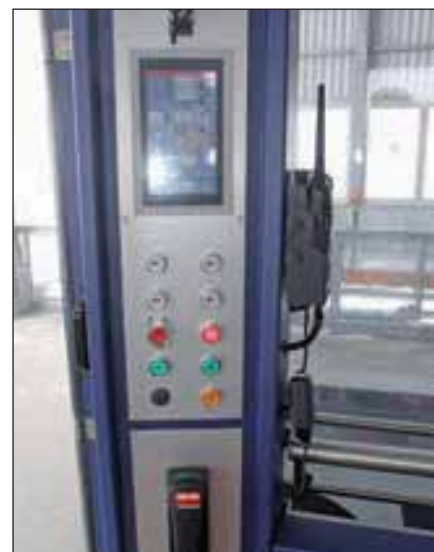
Touchpanel im Fahrzeug: Hier werden diverse Zustände der Anlage angezeigt: Bahngeschwindigkeit, Fahrzeuglast, Statusmeldungen.
