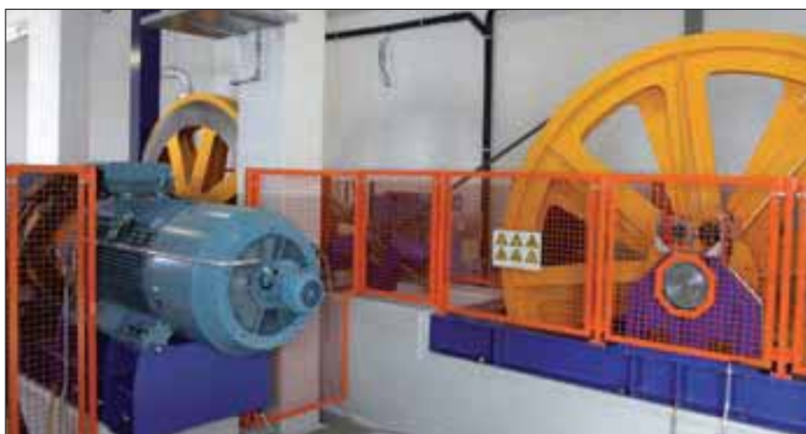
Neuer Antrieb durch einen 710 kW/690-VAC-Asynchronmotor mit Frequenzumrichter.
