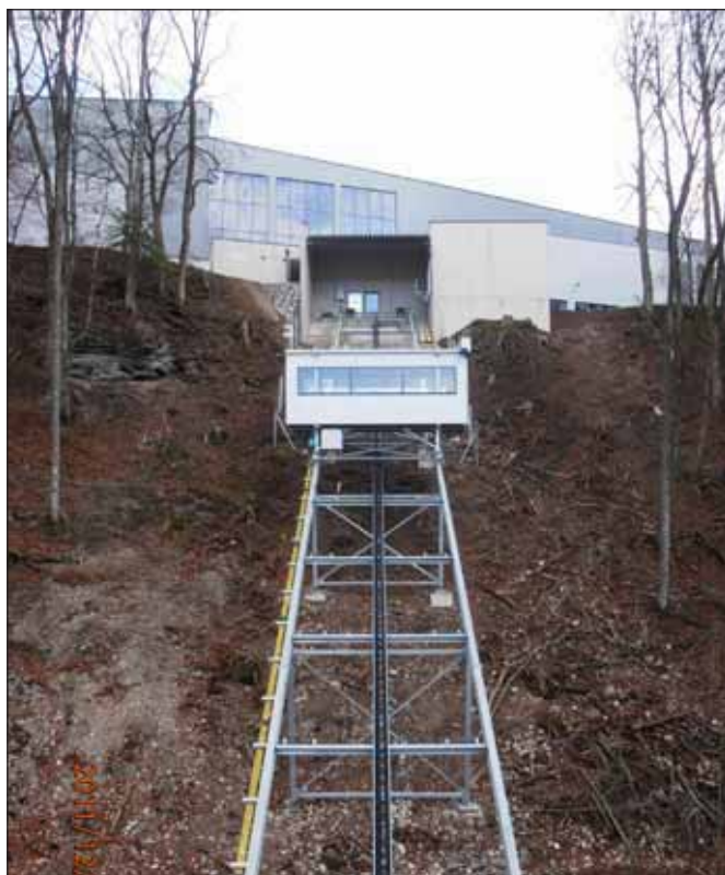
Der 50 Meter lange Schrägaufzug überwindet eine steile Geländestufe.
