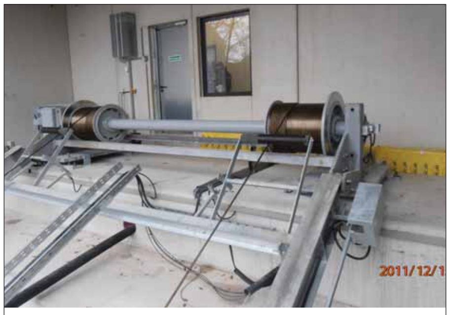
Der Antrieb besteht aus einer durchgehenden Antriebswelle mit zwei Seiltrommeln.
