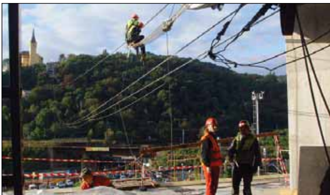
Seilzug für die BARTHOLET-Anlage im tschechischen Ústí nad Labem
