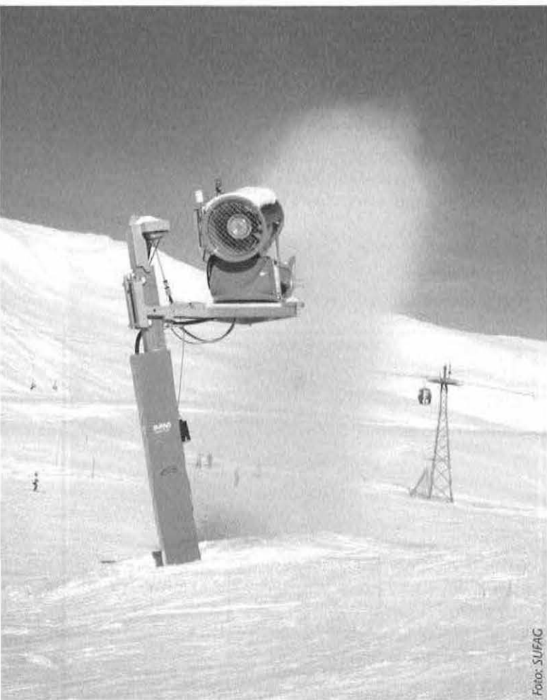
18 Propellermaschinen der Type SUFAG Compact Eco werden u. a. die Schneiflotte auf der Gerlos ergänzen, platziert auf Gunliftern.
