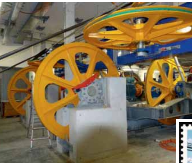
Die aufwändige Zugseilführung im Maschinenraum benötigt zwei zweirillige Antriebsscheiben, zwei Gegenscheiben und sechs Umlenkscheiben.
